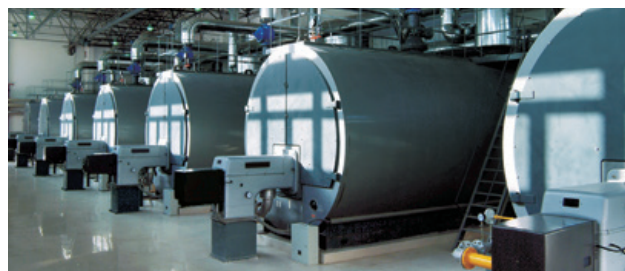
Fig. 100: Centrale termica formata da sette generatori di acqua calda con una potenza totale di 105 MW.
