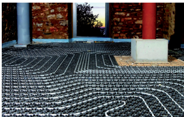
Fig. 72: Le superfici riscaldanti/raffreddanti conferiscono benessere e comfort anche nelle costruzioni di vecchia data
