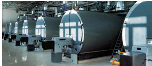
Abb. 100: Heizzentrale, bestehend aus sieben Heißwassererzeugern mit einer Leistung von insgesamt 105 MW
