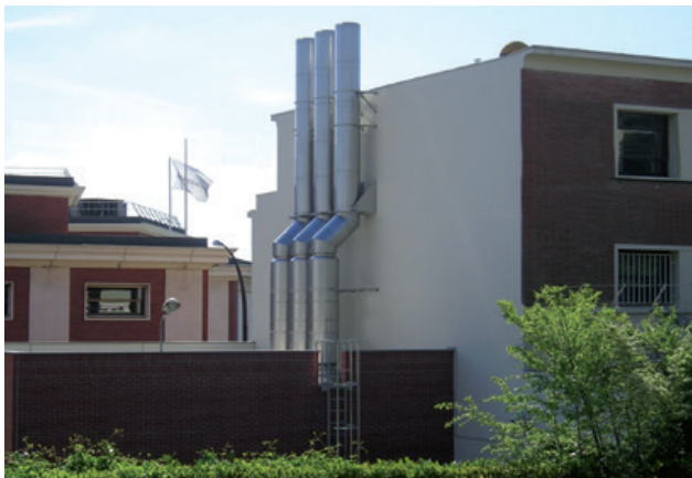
Abb. 94: Edelstahlabgassysteme bei verbrennungsmotorisch betriebenen Feuerungsanlagen
