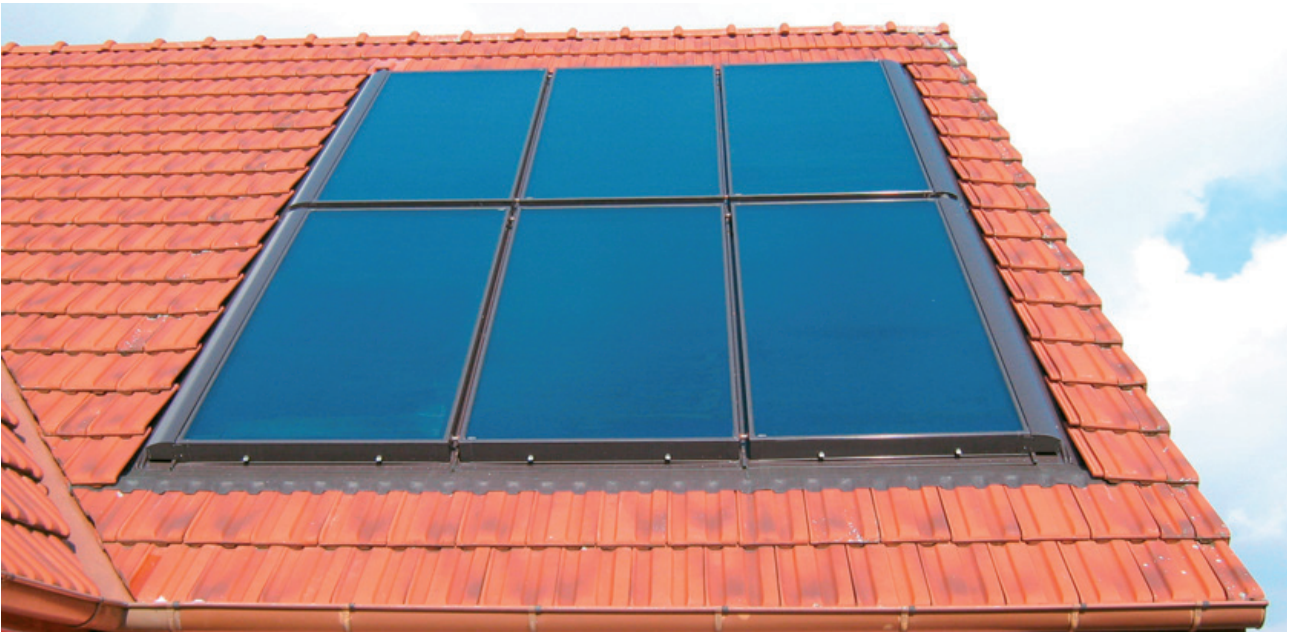
Abb. 56a: Praxisbeispiel für die Anwendung von Solarthermie-Flachkollektoren
