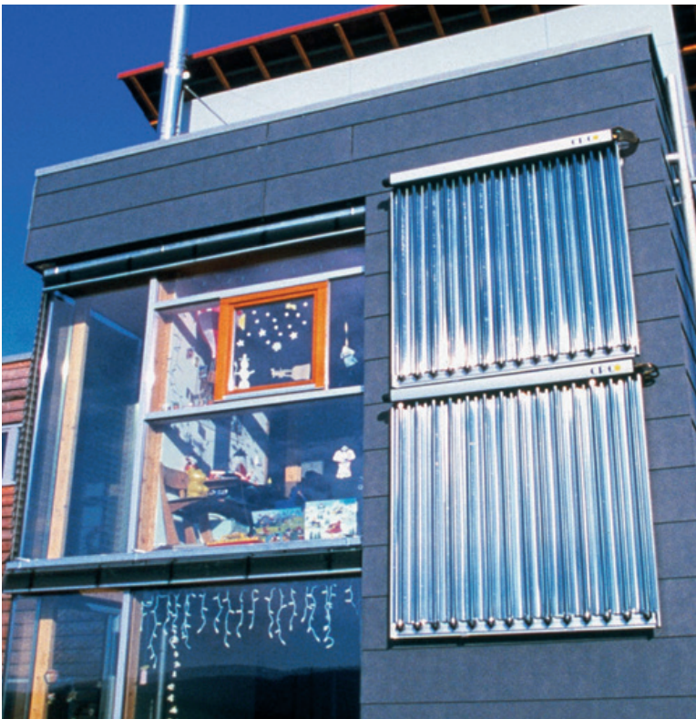
Abb. 53: Praxisbeispiel für die Anwendung von Solarthermie-Vakuumpöhrnenkollektoren
