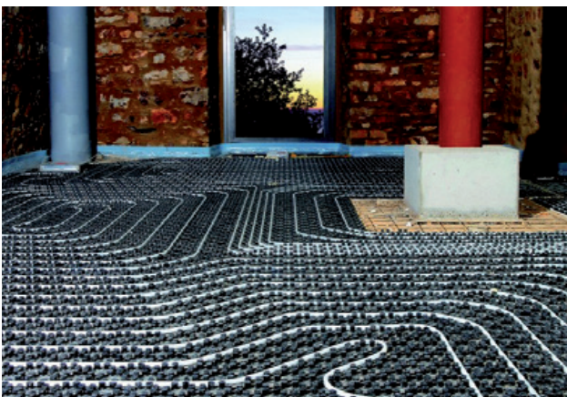
Abb. 72: Flächenheizung/-kühlung sorgt auch im Altbau für Behaglichkeit und Komfort
