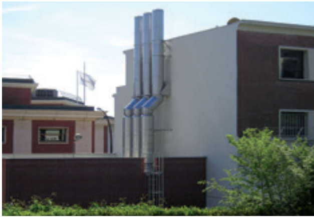
圖 94：燃機操作式火爐設備不鏽鋼廢氣系統
