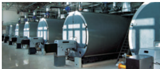
圖 100：由七組熱水製造設備組成的中央供熱系統，可產生高達 105 MW 的熱能
