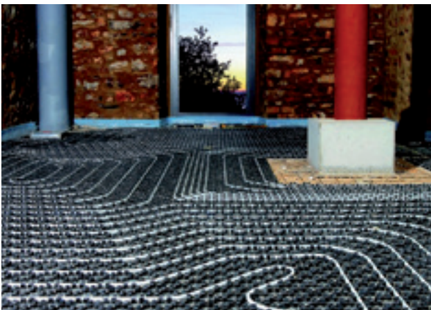
圖 72：輻射板加熱／冷卻系統即使安裝在舊建築物，也能創造舒適宜人的環境
